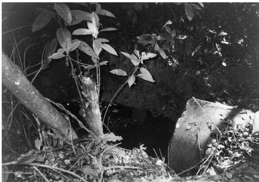
Figura 2. Tubulação de efluentes domésticos e industriais no rio Murucupi.
